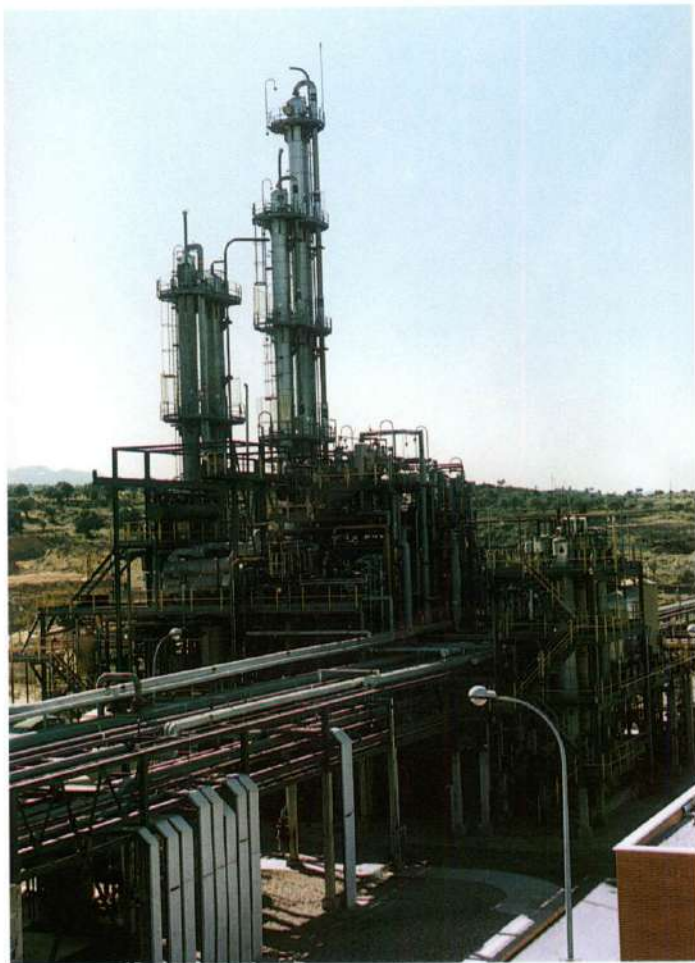
VISTA PARCIAL DE LA PLANTA DE CLOROMETANS, INAUGURADA EL 1990.
