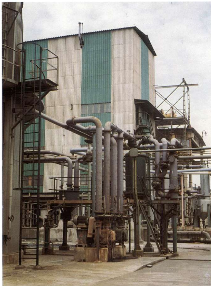
GENERADORS D'ACETILÈ DE LA PLANTA DE TRICLOROETILÈ, CAP ALS ANYS SETANTA.
