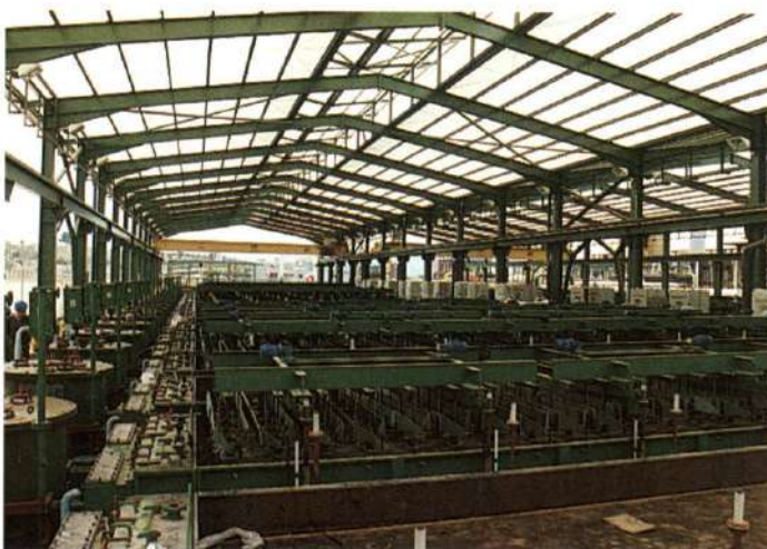
LA INSTAL·LACIÓ DE PRODUCCIÓ DE CLOR EN PROCÉS DE REMODELACIÓ, VISTA DES DE LA CARRETERA DE RIBARROJA.
